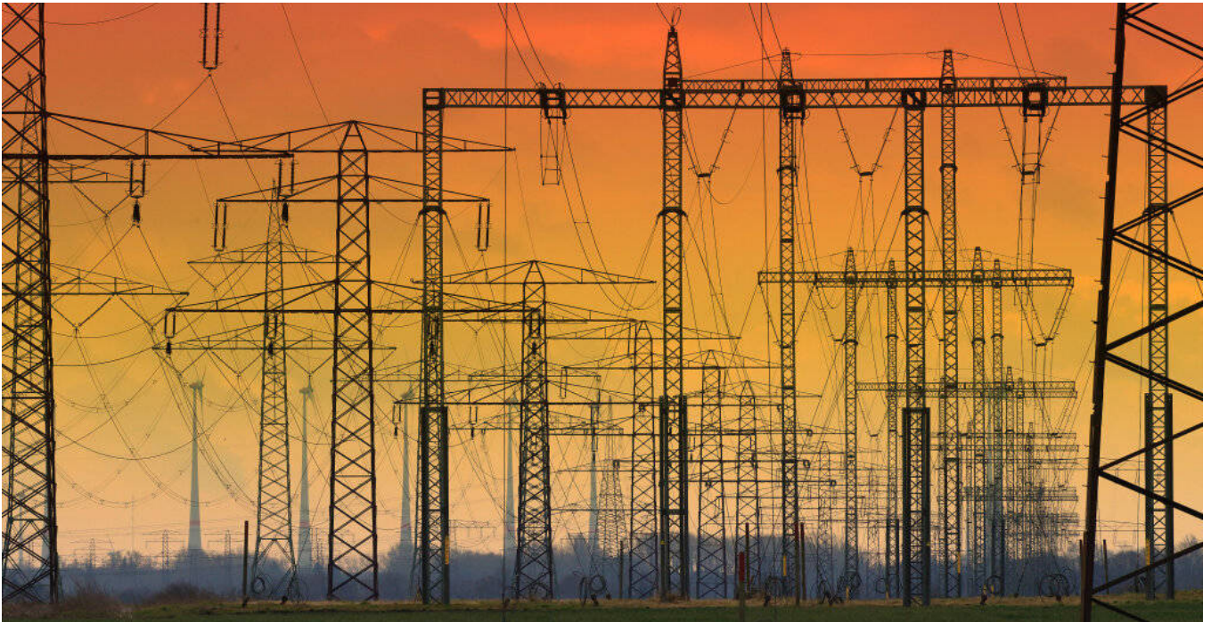
Der Ausbau des Stromnetzes ist eine Riesenaufgabe. Foto: Jens Wolf (dpa)
