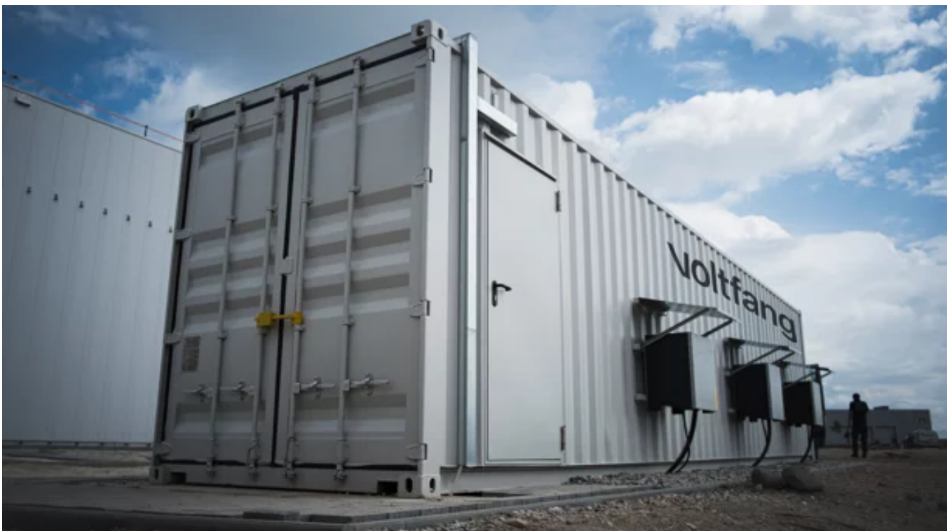
Voltfang-Großspeicher mit Ladesäule
