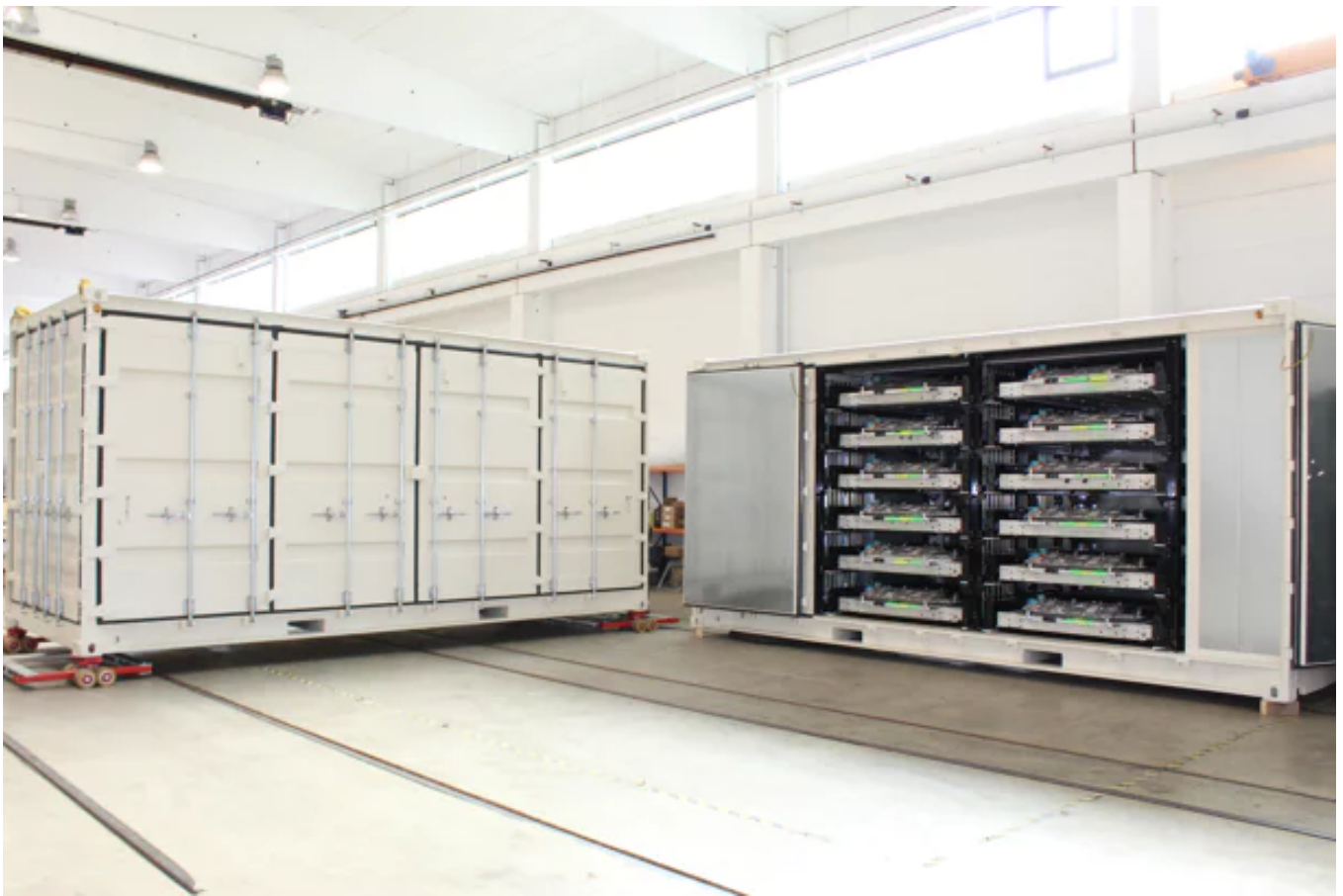
Hybrid-Speicher Gundelsheim aus Natrium-Ionen- und Second-Life-Batterien
