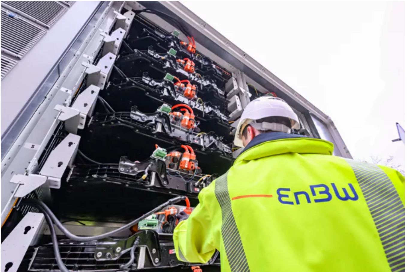
Ein Mitarbeiter kontrolliert ein "Seniorenheim für Autobatterien" von EnBW.
